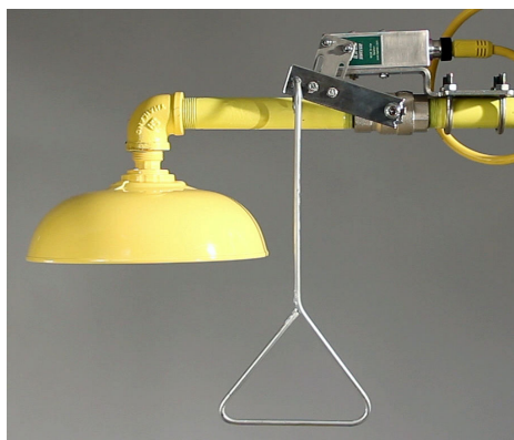
Рисунок 7-1. Переключатель TopWogx, установленный на аварийном душе
