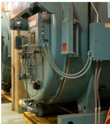
Система горелки котла
