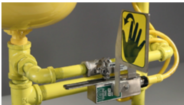
Рис. 7-17. Переключатель TopWorx, установленный на станции для промывки глаз.
