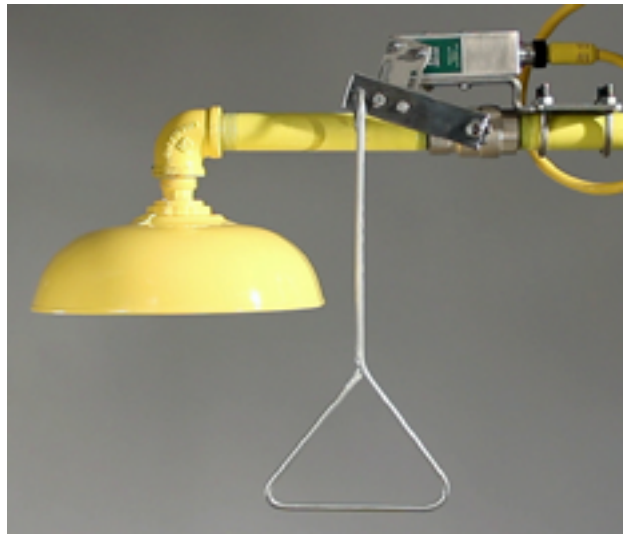
Рис. 7-14. Переключатель TopWorx, установленный на аварийном душе
