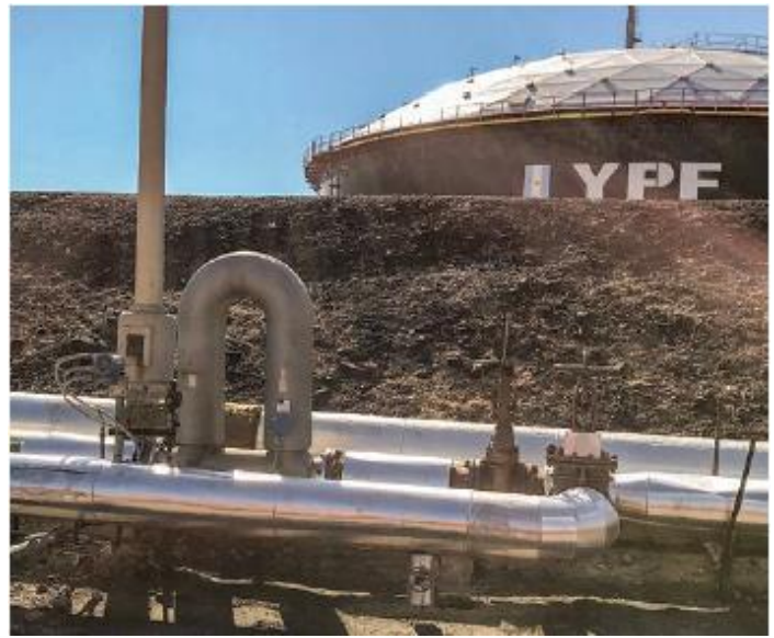
Figura 4. Caudalímetros Coriolis situados en la entrada de un tanque de crudo
