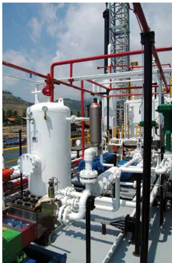
Vannes de régulation Fisher à l'œuvre dans un environnement offshore
