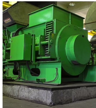
Geradores de gás
