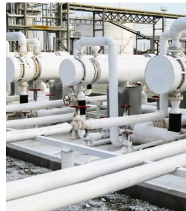
Permutadores de calor
