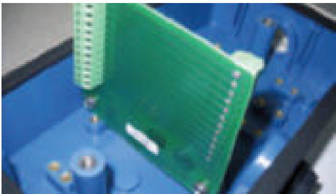
Figura 20: La caja de conexiones PN 23550-00 tiene una tarjeta de extensión, pero no un preamplificador
