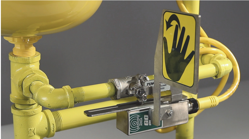
Figur 27. TopWorx-bryter montert på en øyevaskstasjon
