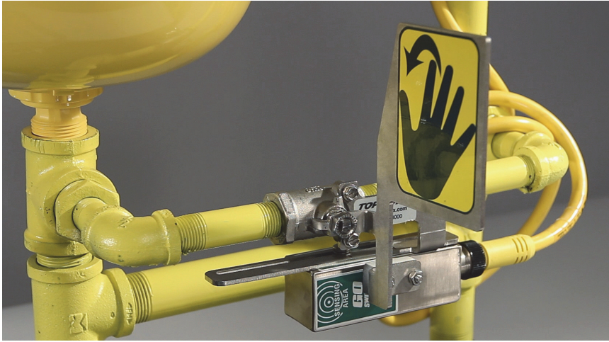
Figur 27. TopWorx-kontakt installeret på en øjenskyllestation
