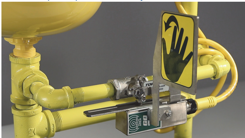
Obrázek 27. Spínač TopWorx nainstalovaný na stanici oční lázně
