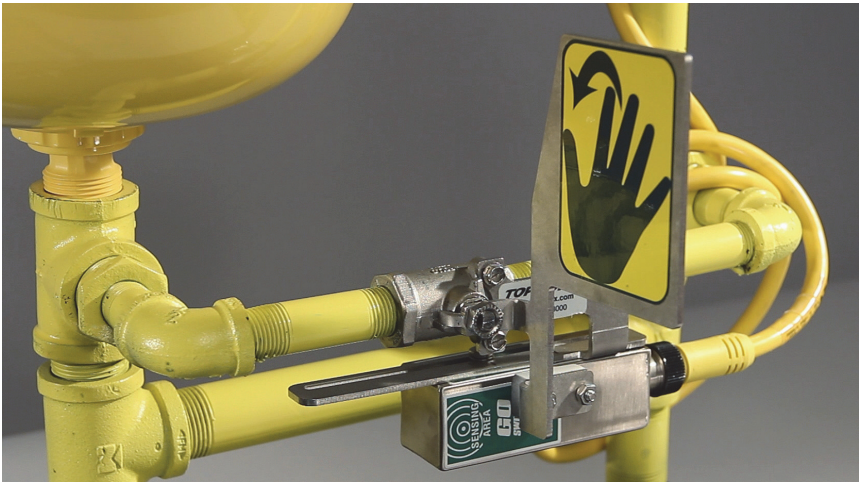
27 ábra. Szemmosó állomásra szerelt TopWorx kapcsoló
