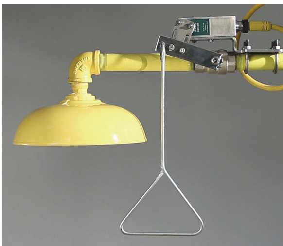
Figur 26. TopWorx-brytaren installerad på en säkerhetsdusch
