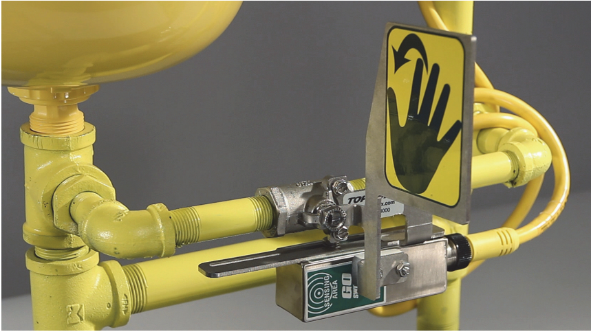
Figur 27. TopWorx-brytaren installerad på en ögonduschstation
