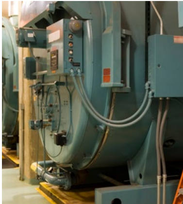
Chaudières et brûleurs
