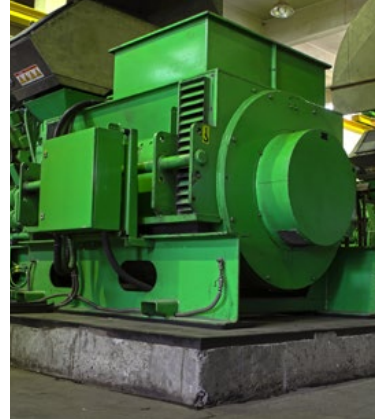
Générateurs de gaz
