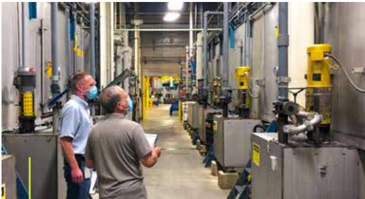
Quiénes participan en la búsqueda del tesoro de energía en el sitio de fabricación de Flow Controls en Marshalltown, Iowa, buscan oportunidades de ahorro durante un recorrido en horas no productivas.
